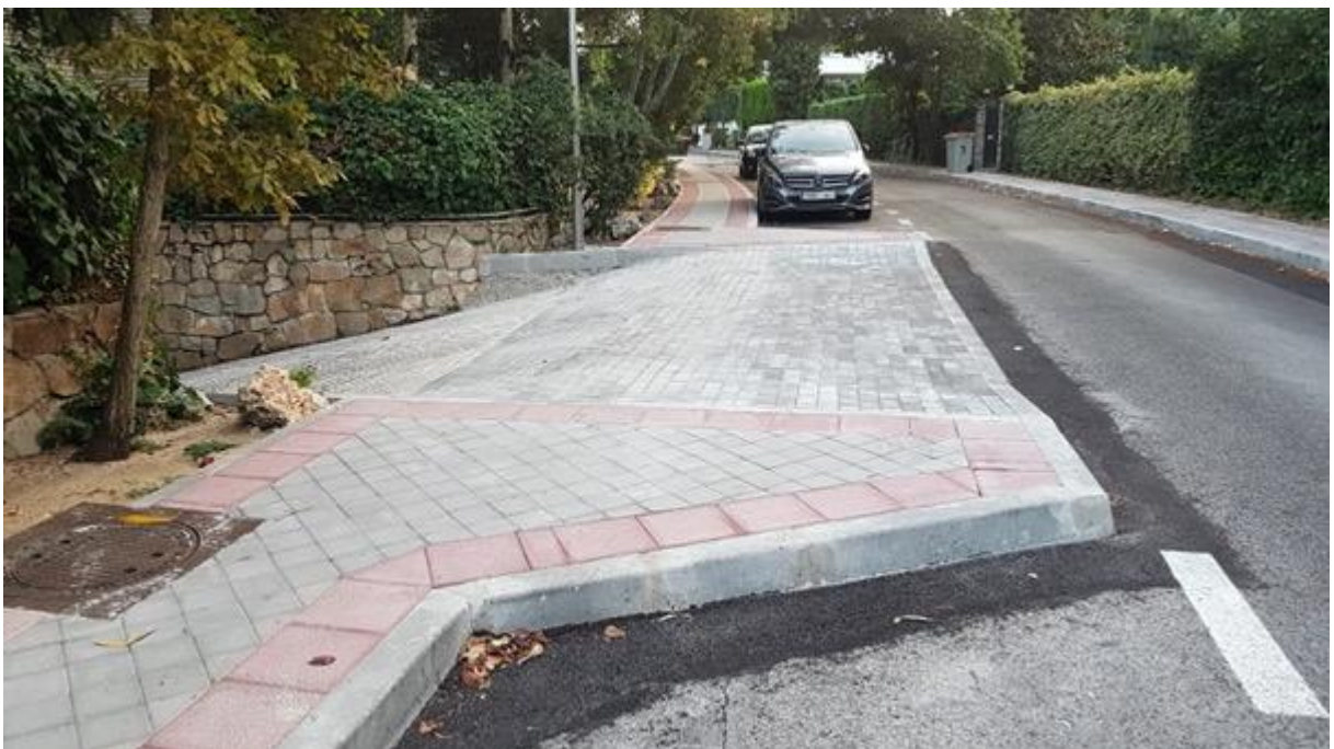
Imagen 14. La construcción del avance de acera ha permitido resolver el desnivel negativo y la continuidad del itinerario peatonal. Se debe complementar con vallas para resolver los escalones
