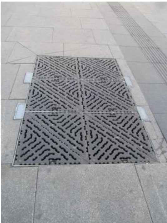
Imagen 12. Detalle de rejilla accesible ubicada en itinerario peatonal accesible cumpliendo con las dimensiones mínimas. Diseño Metro de Madrid
