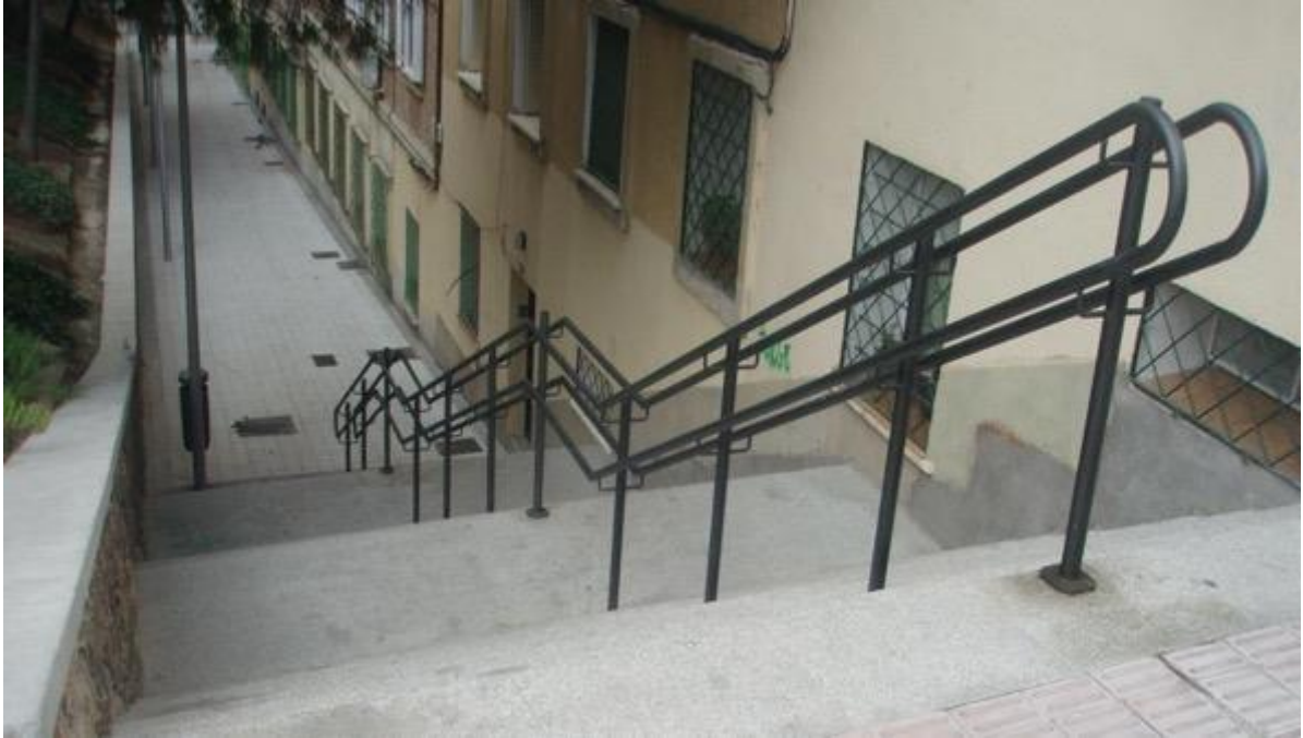
Imagen 9. Disposición de pasamanos en la zona central al no ser posible adosarlo al lateral derecho por la presencia de ventanas en la fachada en la calle Vertiente
