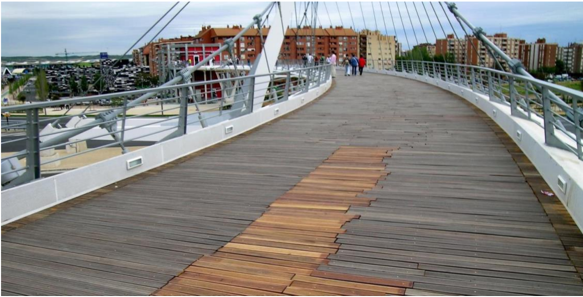
Imagen 12. Pasarela peatonal en Zaragoza. En estos casos la rápida respuesta de los servicios de conservación es fundamental para evitar accidentes
