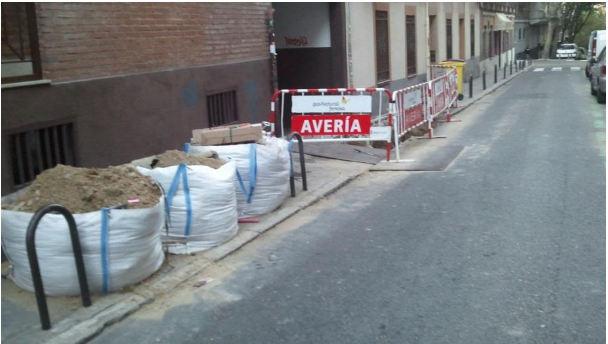
Imagen 6. Los acopios de material deben realizarse fuera del itinerario peatonal de las aceras y protegidos en todo su perímetro (lo que no ocurre en la imagen)
