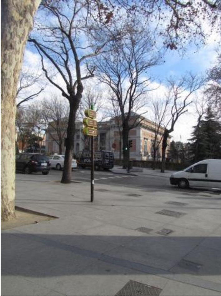
Imagen 17. Tapas de registro enrasadas en el itinerario peatonal accesible
