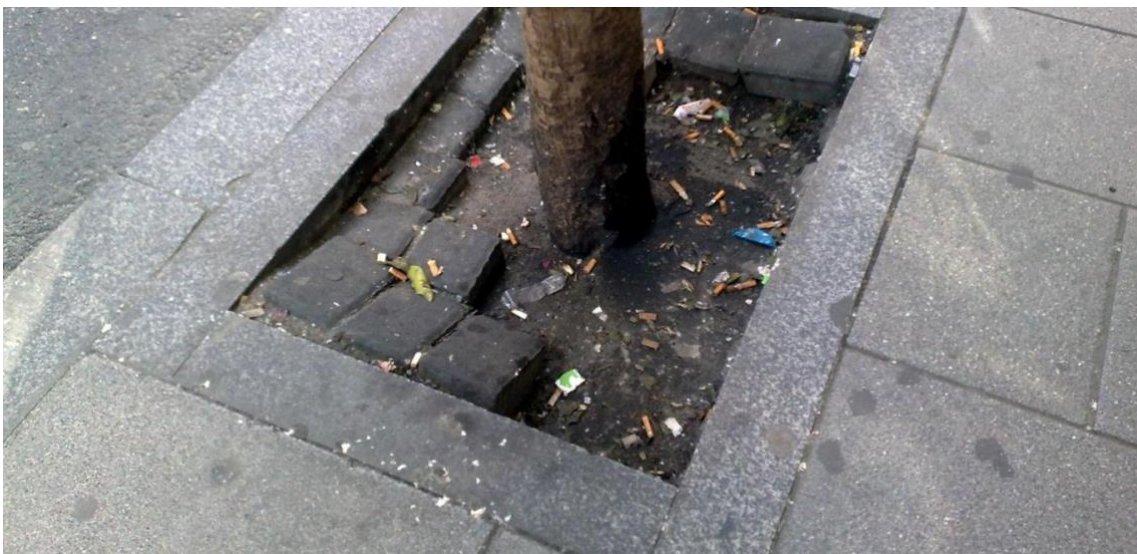
Imagen 5. La pérdida de árido en el alcorque conlleva el hundimiento del adoquín y posteriormente la pérdida de piezas, generando un desnivel no previsto que debe corregirse
