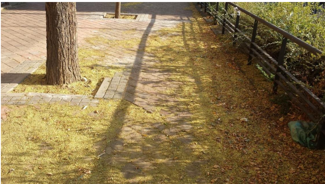
Imagen 2. La falta de limpieza en el pavimento genera situaciones no contempladas en su diseño, perdiendo el pavimento su condición de antideslizante
