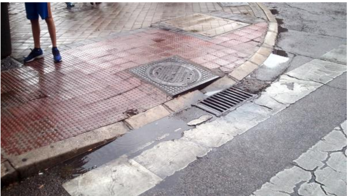
Imagen 16. Imbornal en vado peatonal en la calle de Clara del Rey. Hay que evitar la ubicación de imbornales y sumideros en la superficie del paso de peatones
