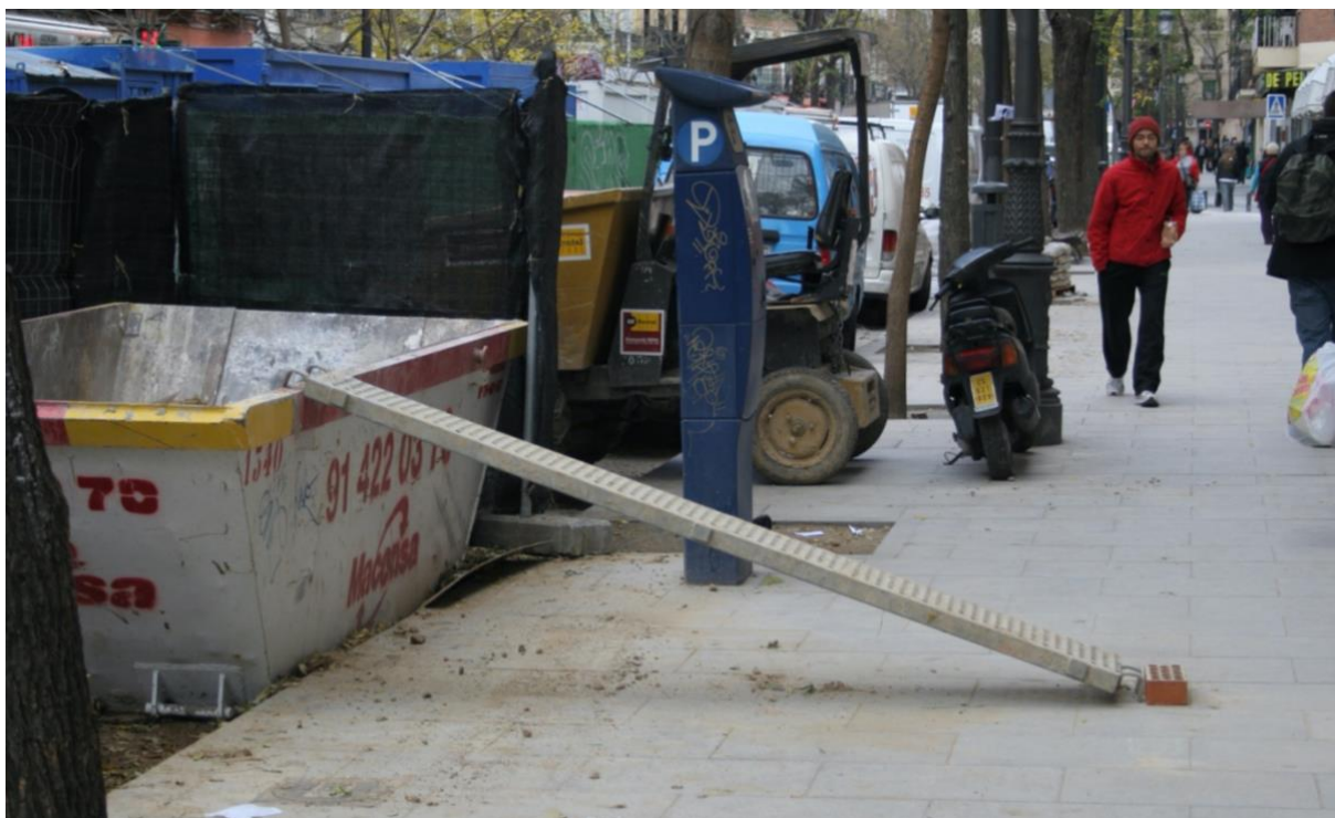
Imagen 9. Incluso cuando los trabajos sean de carácter temporal no se interrumpirá su correcta señalización y las pertinentes medidas de seguridad que eviten accidentes en la vía pública. La imagen muestra una evidente situación de riesgo para las personas
