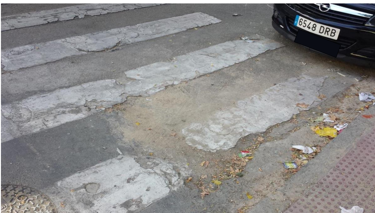
Imagen 11. Pintura y firme deteriorado en el cebreado del paso de peatones
