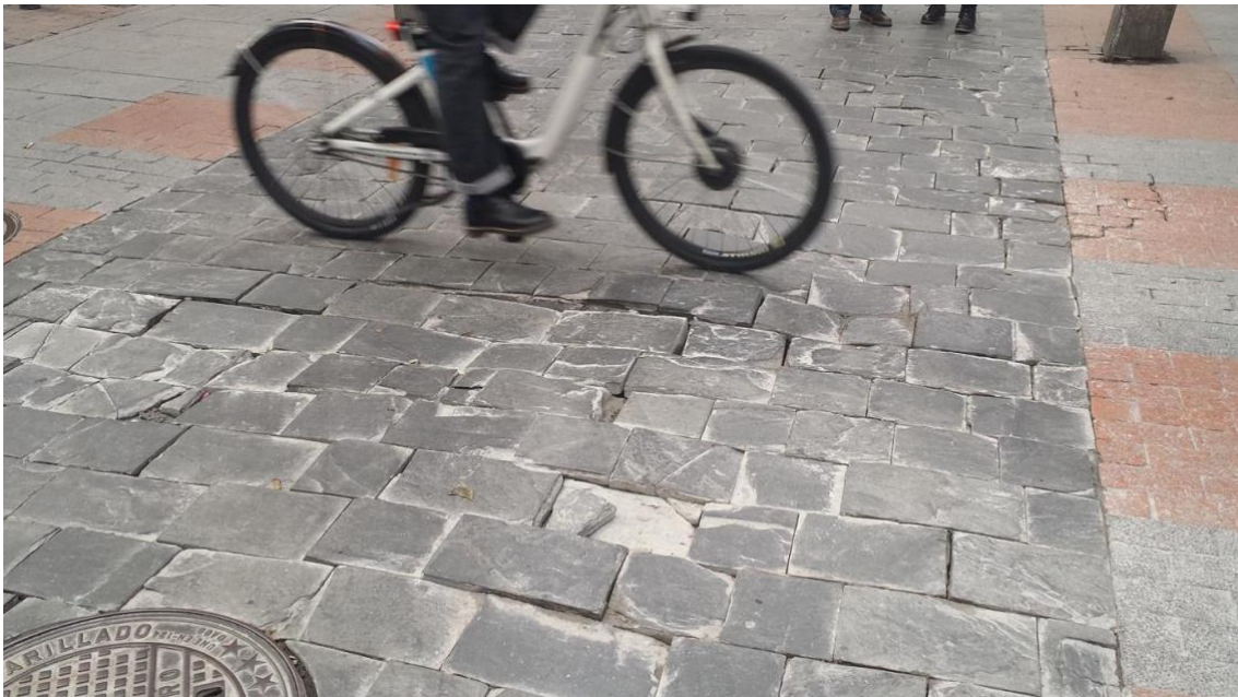
Imagen 3. En la imagen, el deterioro del pavimento provoca situaciones de tropiezo y limitaciones para el uso de cualquier vehículo de ruedas
