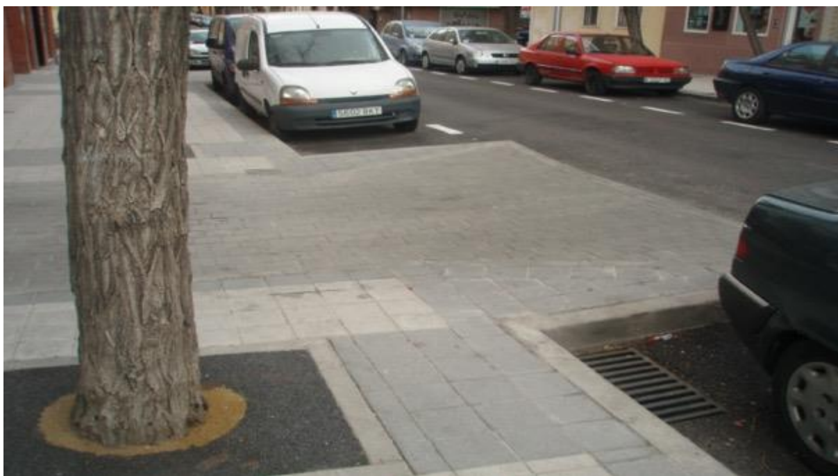
Imagen 1. Vado de vehículo en Avenida de Daroca. En este caso se construye una plataforma que ocupa la banda de estacionamiento
