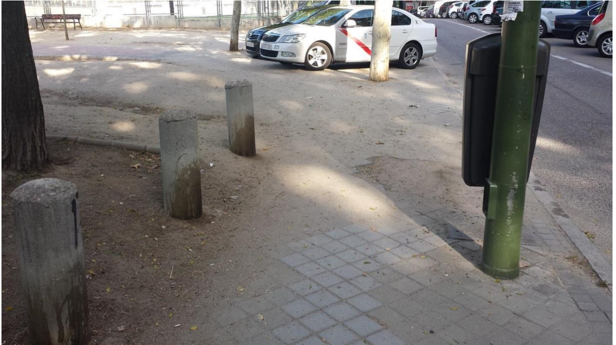
Imagen 14. En la imagen se muestra como las aguas de lluvia han depositado parte de las tierras del parque anexo en la acera, que por falta de limpieza llega a desaparecer
