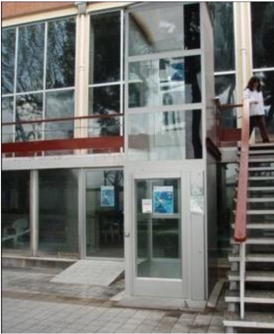
Imagen 2. Plataforma elevadora vertical. Real Club Canoe
