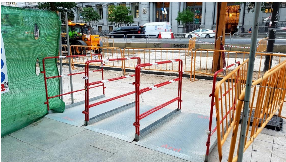
Imagen 8. Cuando sea necesario construir itinerarios alternativos entre los niveles de calzada y acera los planos inclinados que se generen tendrán la condición de rampas, y como tales ajustarán su pendiente a un máximo de 10% y se dotarán de pasamanos laterales y zócalo inferior
