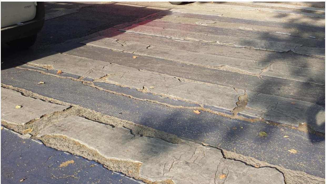
Imagen 15. Deterioro de la pintura de cebreado del paso de peatones, lo que genera multitud de resaltes y hundimientos que deben corregirse
