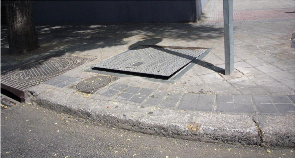
Imagen 8. Tapa de registro sin cerrar que produce un resalte en el pavimento de la acera
