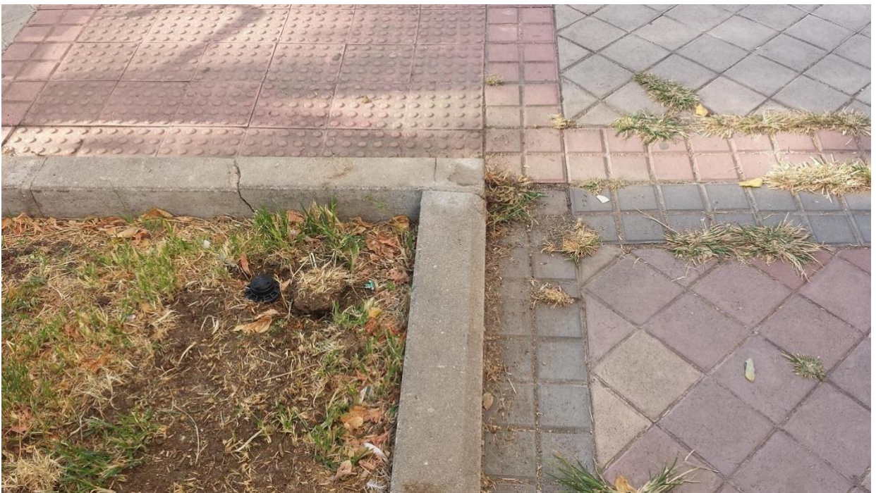
Imagen 13. Las inmediaciones de los parterres y alcorques son zonas muy proclives a la proliferación de vegetación en las juntas del pavimento, lo que debe controlarse
