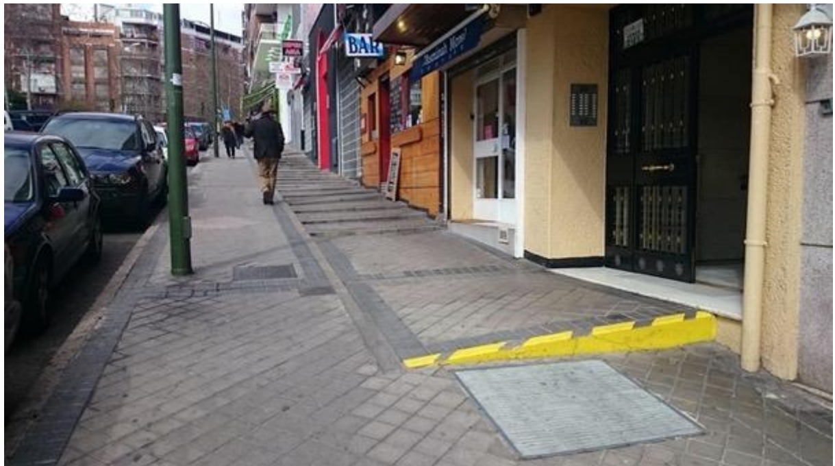
Imagen 12. Acera con elevada pendiente longitudinal en la calle de Santa Hortensia. En estas situaciones existe una evidente dificultad a la hora de compatibilizar los requerimientos del itinerario peatonal accesible, la topografía del entorno y el acceso a las fincas
